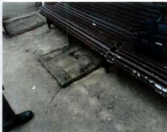
Caixas da rede de esgotos do Cemitério
